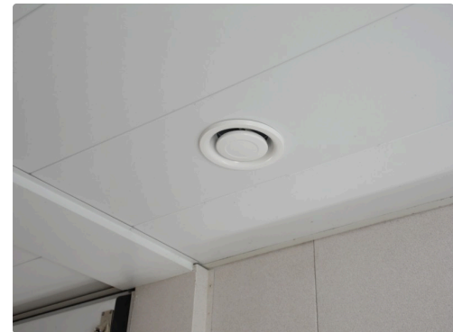
Une ventilation intérieure a été mise en place photo marcel lavedan
