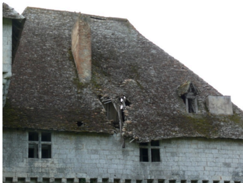
Un pan de toiture effondré.
