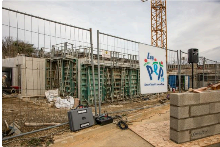
Un feu s'est déclaré sur une partie du bâtiment en construction de l'institut médico-éducatif
