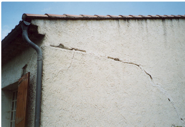
Retrait Gonflement Argile : un financement de l'État pour protéger les maisons avant l'apparition de dégâts
