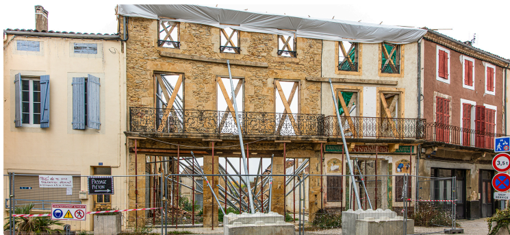
Aignan : à quand les travaux de réfection du bâtiment effondré sur la place ?
