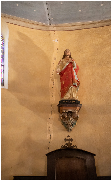
Fissure à l'intérieur
