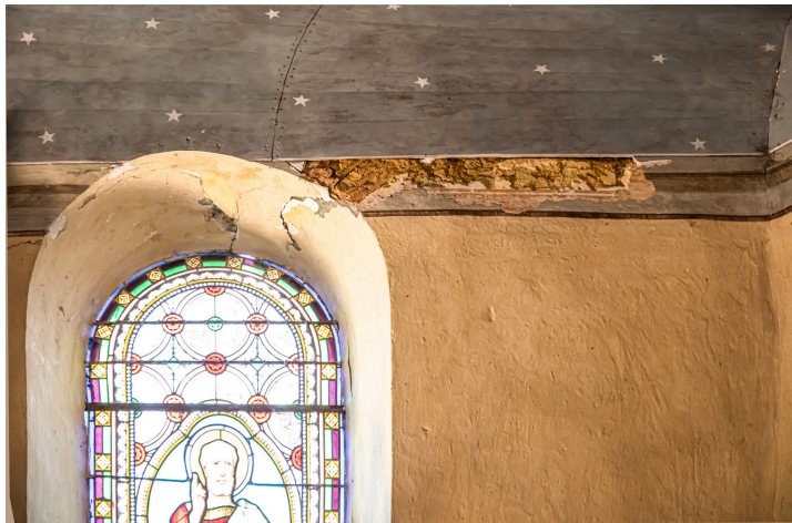
Dégâts à l'intérieur
