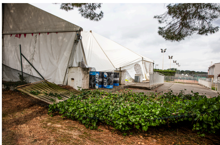
Au 1er plan, la clôture du stade est renversée ; en arrière plan, le chapiteau a souffert
