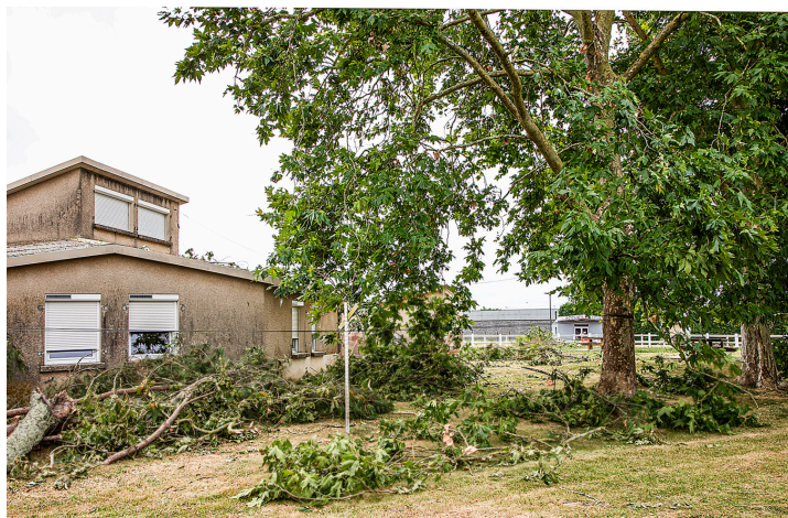
Dégâts sur l'arrière du gîte d'étape
