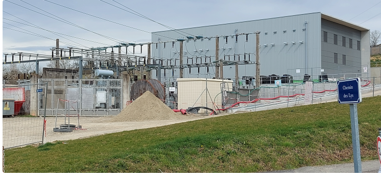
Visite inédite du poste électrique !
