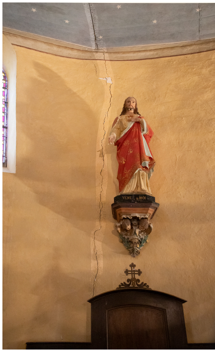
Fissure vue de l'intérieur
