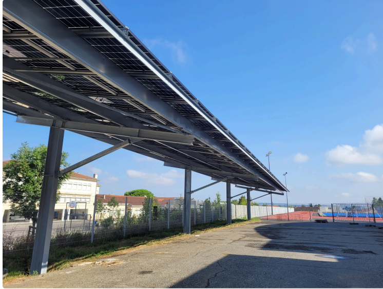
Une ombrière photovoltaïque a été mise en place à la halle des sports de L'Isle-jourdain.
