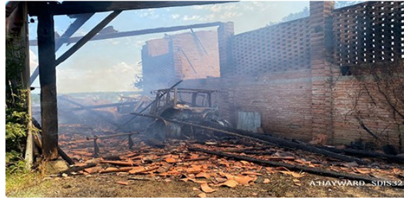
Un hangar agricole la proie des flammes
