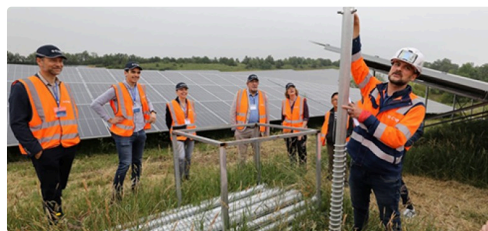
aurade parc solaire cve 4.jpg
