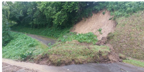
intempéries meteo gers route eauze.jpg
