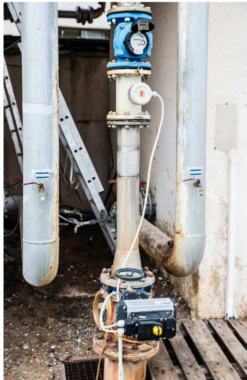
Le compteur de débit d'eau
