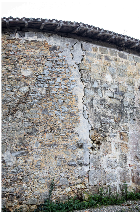
Fissure à l'extérieur
