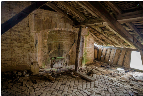
Le toit a été rabaissé au-dessus de cette cheminée du dernier étage; le carrelage est très beau
