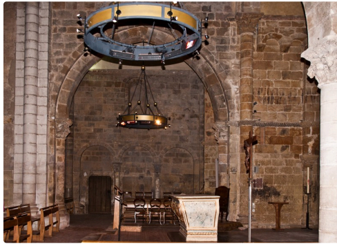
Le chauffage-éclairage par lustres, lors de son installation en décembre 2011
