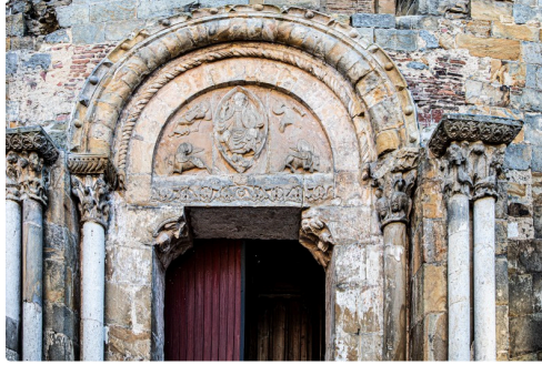
Le portail est de l'église de Nogaro avec la protection métallique de l'arc
