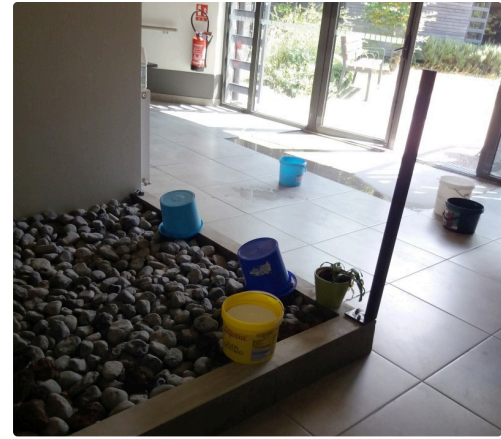
de multiples infiltrations dans l'établissement ©chantal Bassi
