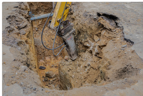
Le pan du mur écorné pour frayer un passage
