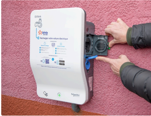
Prises pour branchements de câbles et en bas à gauche emplacement pour badger
