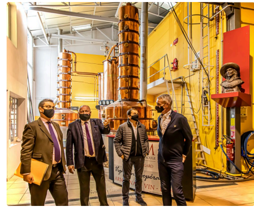
Dans la salle de distillation
