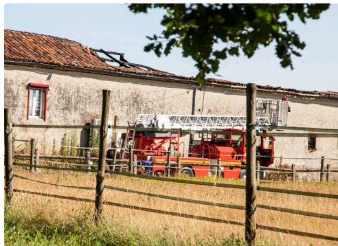
On distingue que le toit est endommagé
