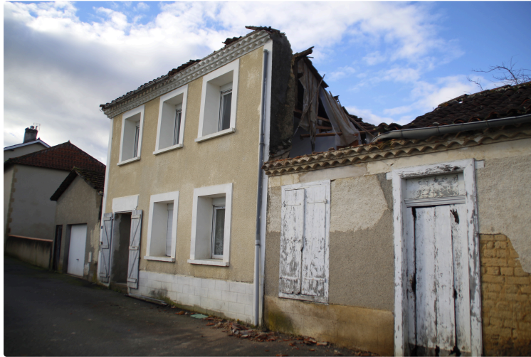
Une maison s'effondre le propriétaire occupant des lieux sort bien
