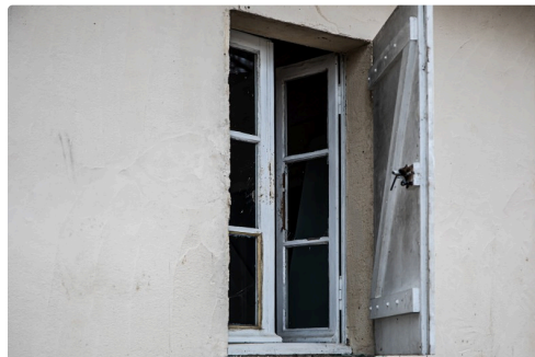
Fenêtre fracturée au local des chasseurs
