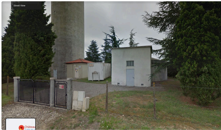
Coupires d'eau sur le réseau SIDEAU
