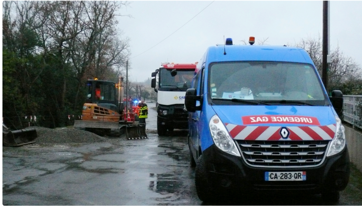
Cambriolage et 100 foyers impactés par la rupture d'une conduite de gaz
