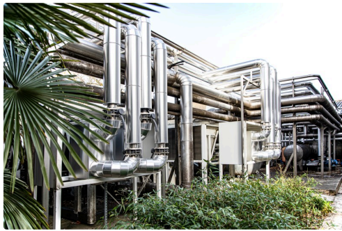
Ces tuyaux transportent la chaleur
