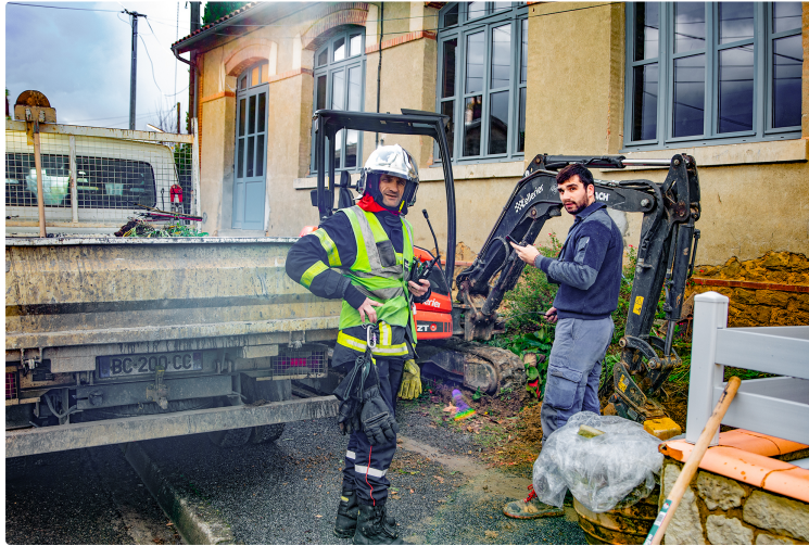
Fuite de gaz sans gravité rue d'Estalens, à Nogaro
