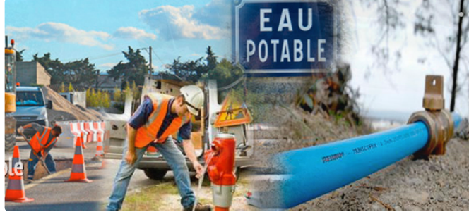
Le SIEBAG (Syndicat Intercommunal des Eaux du Bassin de l'Adour Gersois)
