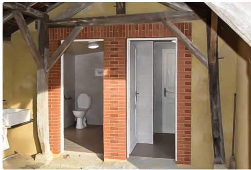
Les sanitaires flambant neuves - Photo communiquée par la mairie de Sainte-Christie-d'Armagnac
