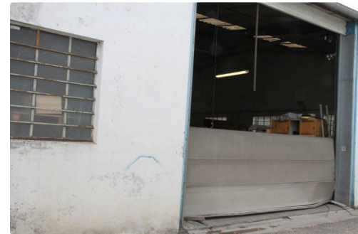
Porte de l'entrepôt.
