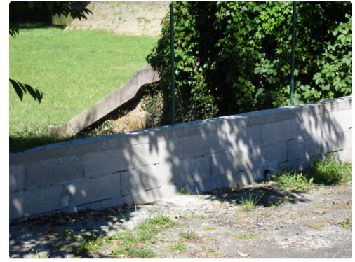
Un muret remplace un grillage pour empêcher aux resquilleurs un accès hors heures d'ouverture
