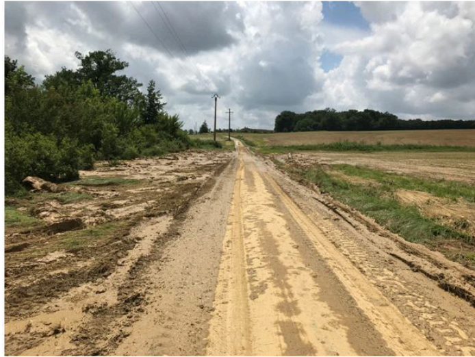
La voirie gravement endommagée
