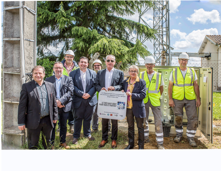
Nogaro – Des armoires pour le très haut débit avec la fibre optique
