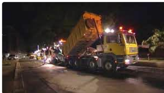
Travaux de réfection de chaussée sur la RN 524 sur la commune d'EAUZE du lundi 3 avril au mardi 25 avril 2017
