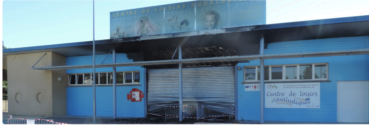
Le centre aqualudique de Condom fermé suite à un incendie
