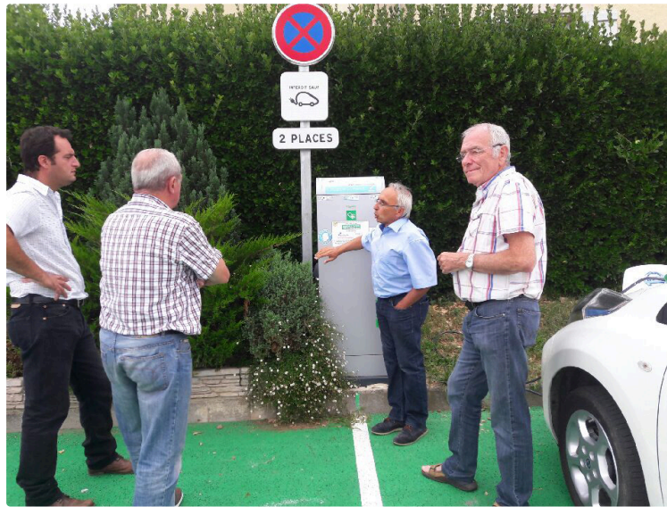
Bornes électriques en service sur Mirande
