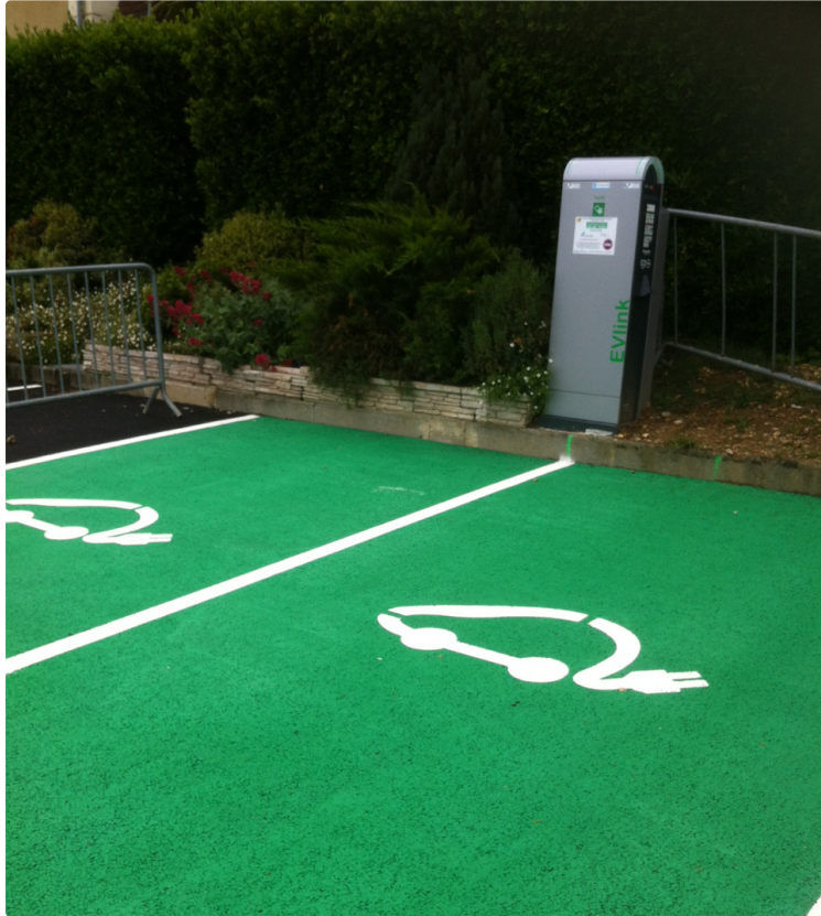
Bornes de recharge électrique pour véhicules
