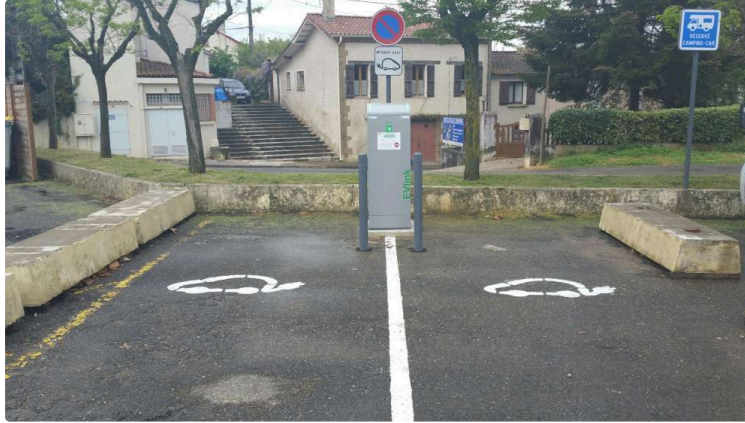
Borne de recharge électrique
