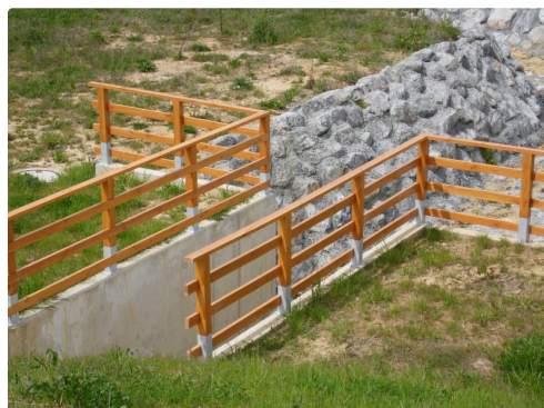
Sécurité aussi au bas du déversoir
